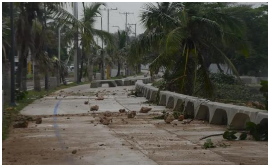
Imagen 3.- Escombros lanzados por el fuerte oleaje y que obligaron a suspender el transito en una de las principales avenidas de la ciudad capital.
